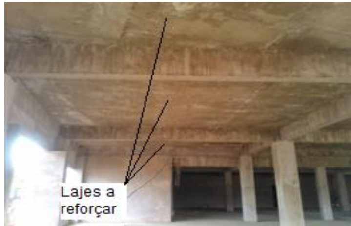
Figura 37 – Lajes a Reforçar com deformação excessiva
