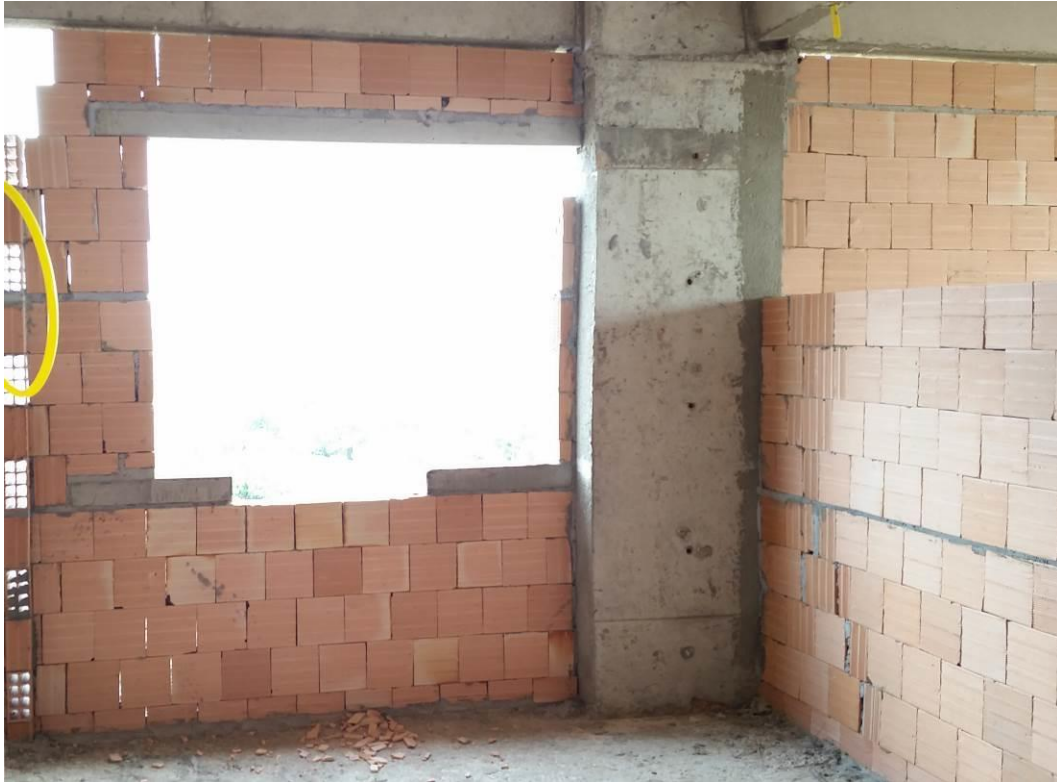
Figura 23 – Colocação da verga, contra verga e encunhamento sem necessidade de quebra dos tijolos
