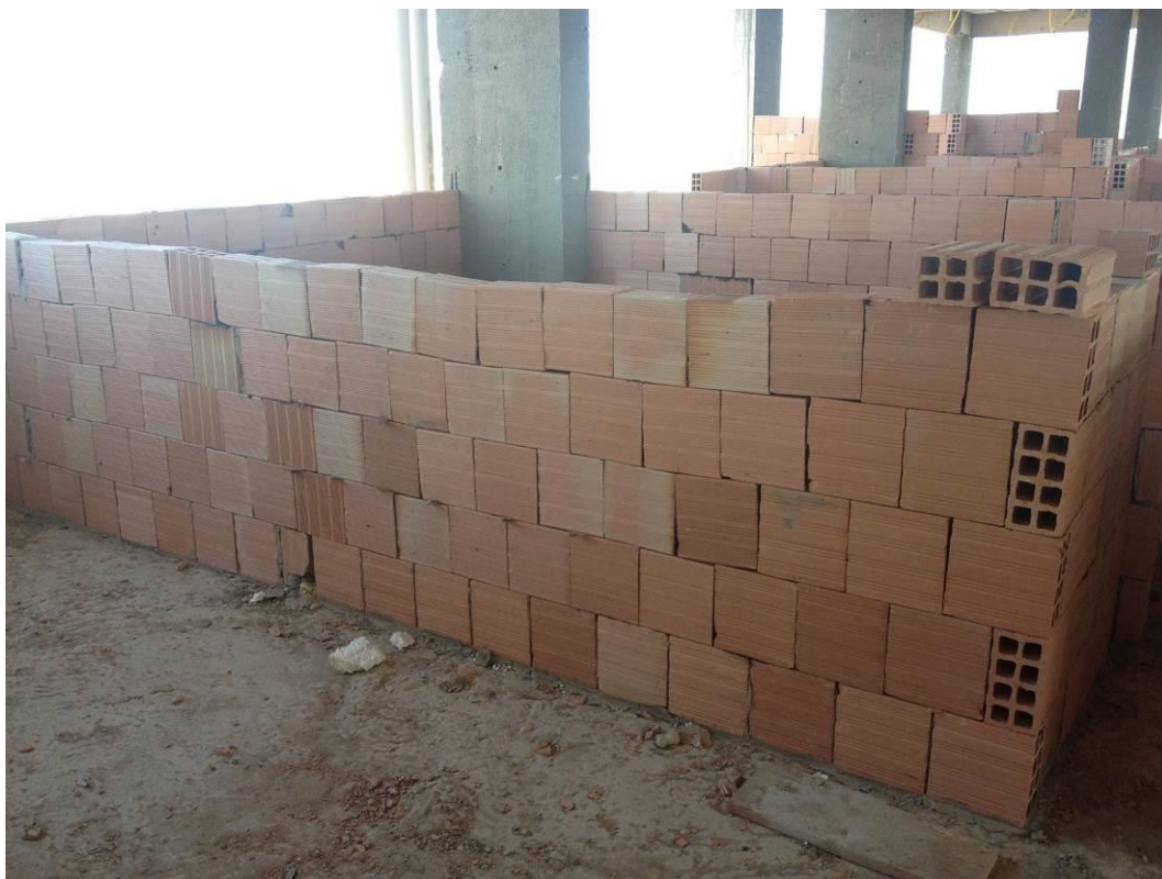
Figura 19 – Falta de nivelamento das fiadas com argamassa pronta ocorrido nos primeiros testes
