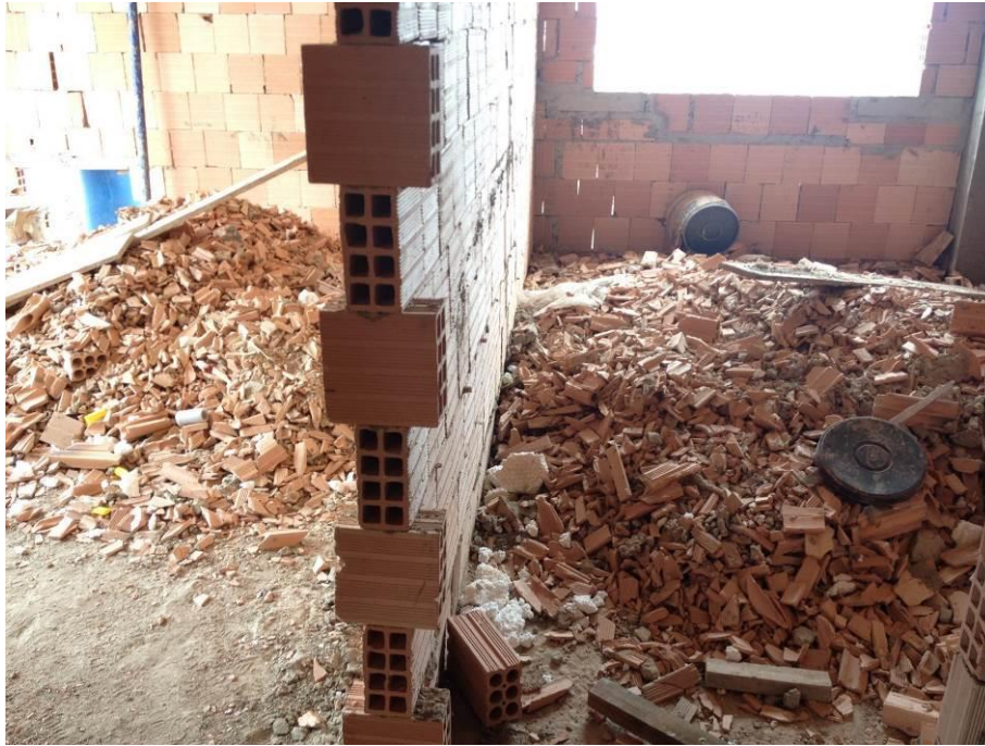
Figura 27 – Quebra de alvenaria sem reaproveitamento devido à utilização de argamassa pronta
