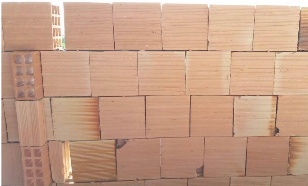
Figura 26 – Espaços existente entre os tijolos de parede externa devido à ausência de junta vertical
