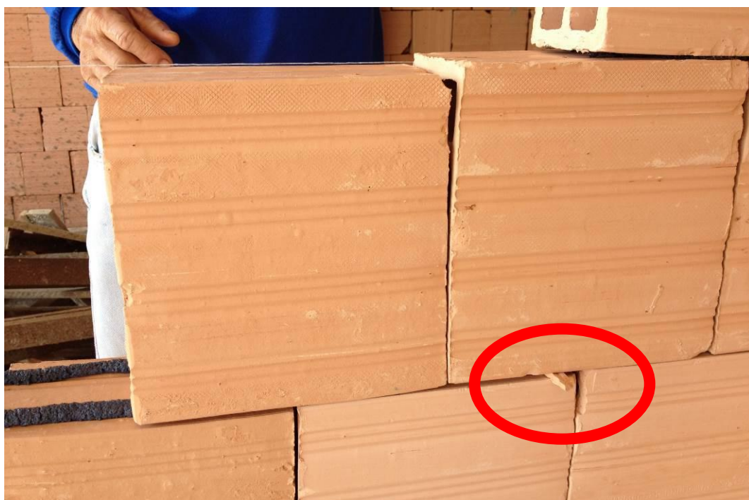
Figura 20 – Utilização de lascas de tijolo para compensar defeitos nos tijolos
