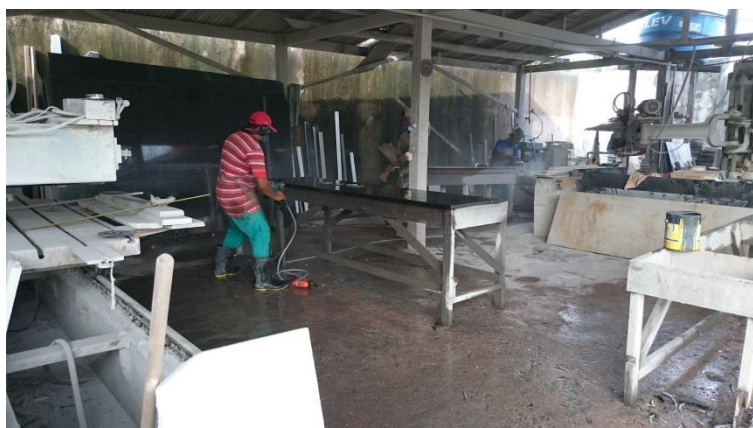
Figura 14 - Inexistência de canaletas de drenagem no processo de lixamento.
