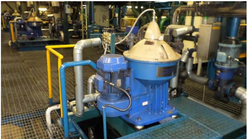
Figura 4.11: Separadoras de óleo lubrificante (Manauara, 2015)
