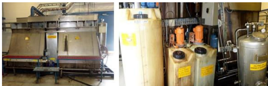
Figura 4.13: Sistema de tratamento de água oleosa (UTE Manauara, 2015).
