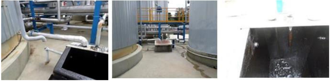
Figura 4.7: Caixa de drenagens de água oleosa da decantação dos tanques de óleo combustível (Manauara, 2015)
