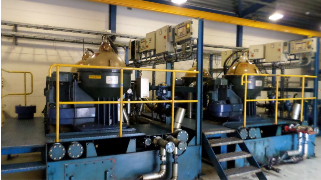
Figura 4.10: Centrifugas de tratamiento de óleo combustível (Manauara, 2015)
