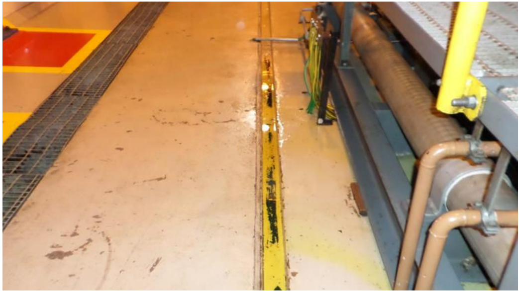
Figura 4.8: Canaletas da Sala de Compressores (Manauara, 2015)
