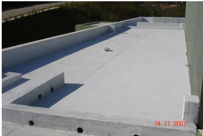
Figura 11 - Área de captação de águas pluviais em laje de cobertura. Fonte: Própria.
