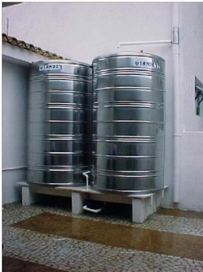
Figura 19 - Reservatório de aço inoxidável. Fonte: ALT, 2012.
