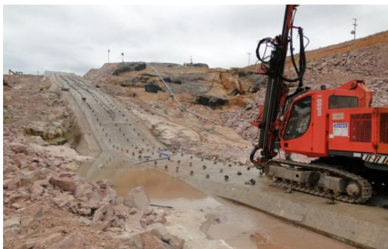
Figura 1.11 Injeções de calda de cimento sobre pressão para tratamento da fundação. Fonte: RAMALHO, Marcelo Carlos. et al (2013)
