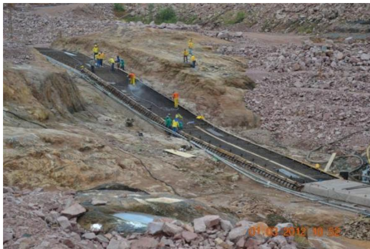
Figura 1.10 Execução de placa de concreto estrutural Fonte: RAMALHO, Marcelo Carlos. et al (2013)
