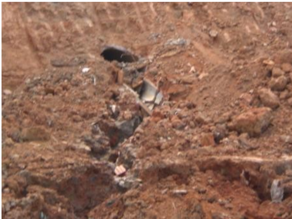
Figura 14: Lançamento de águas pluviais na orla de Humaitá Fonte: IP4, 2007
