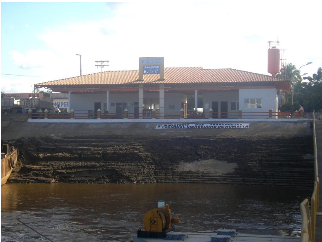
Figura 19: Acúmulo de sedimentos no talude. Fonte: IP4, 2010.
