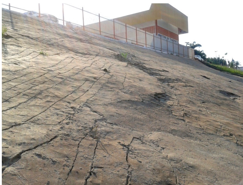
Figura 21: Trincas no talude. Fonte: IP4, 2010.
