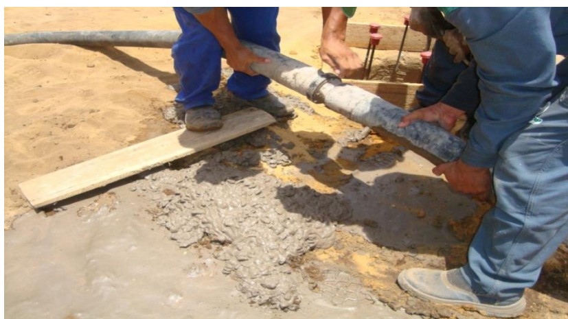
Figura 41 – Perdas no canteiro de obra.
