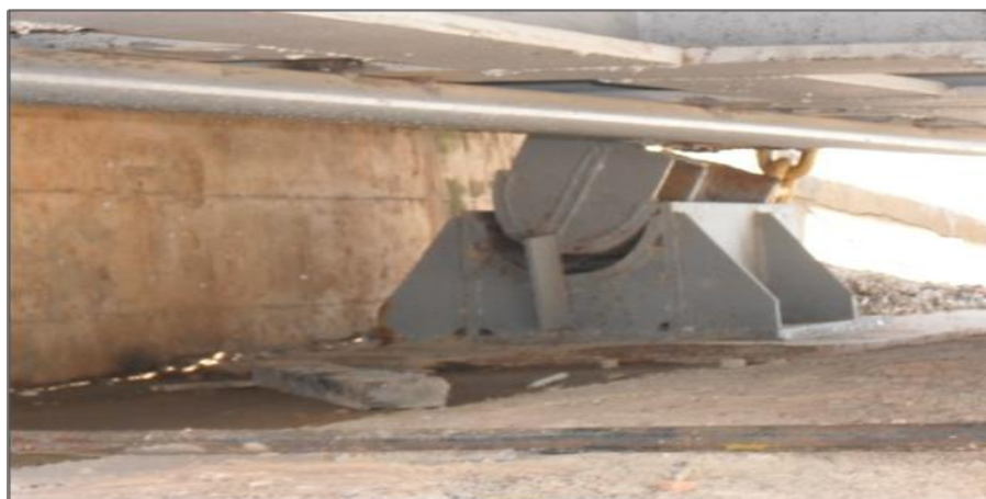
Figura 64: Colapso na estrutura do mancal. Fonte: IP4, 2011.
