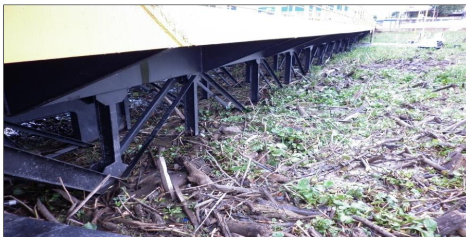
Figura 70: Troncos e vegetação presos na treliça da ponte. Fonte: ERIN, 2011.
