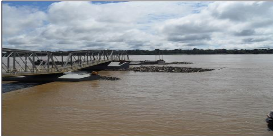
Figura 60: Acúmulo de madeira e vegetação nos cabos e flutuantes. Fonte: IP4, 2011.
