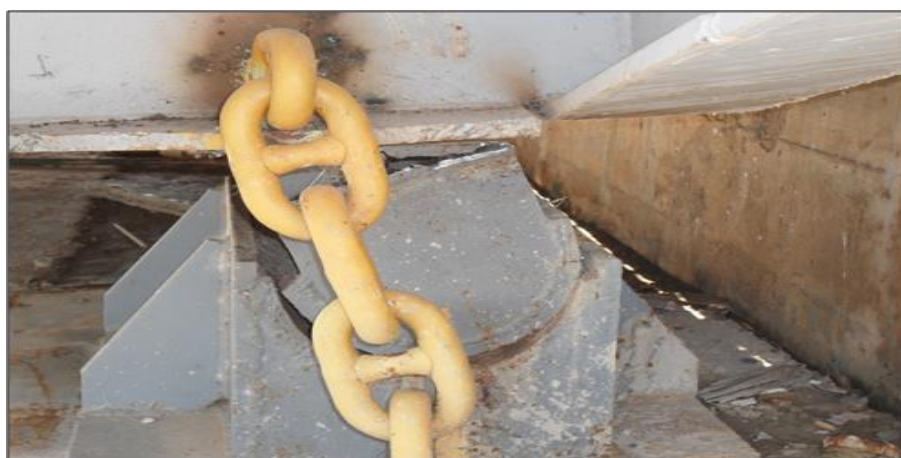
Figura 63: Avaria no mancal de apoio devido ao acúmulo de entulho. Fonte: IP4, 2011.
