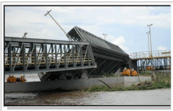
Figura 1 - Incidente ocorrido no Porto de Manacapuru/AM Fonte: DEC – Departamento de Engenharia e Construção - Exército Brasileiro, 2005.
