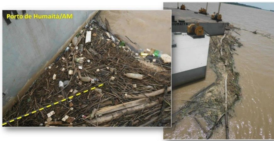
Figura 34: Acúmulo de material vegetal nos cabos – Porto de Humaitá/AM. Fonte: Adm. Porto Humaitá.
