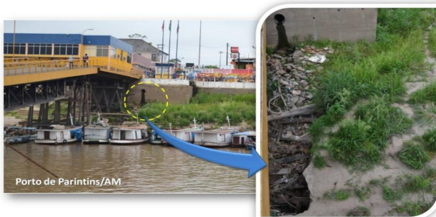
Figura 57: Lançamento de efluentes (erosão) – Porto de Parintins/AM. Fonte: DOC, 2011.
