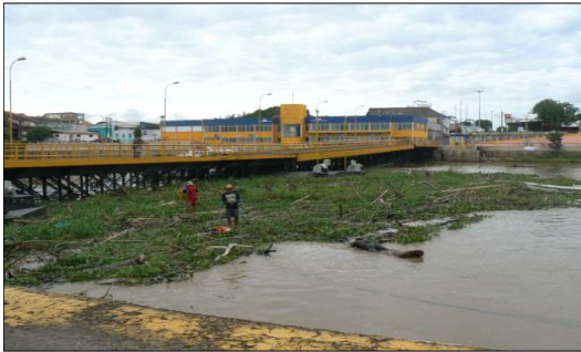
Figura 65: Acúmulo de material na estrutura do Terminal de Parintins/AM
