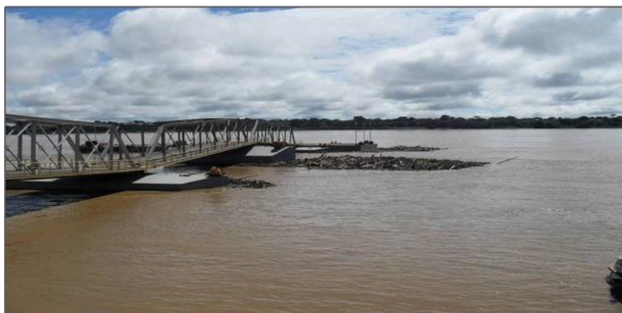
Figura 31: Terminal portuário do município de Humaitá–AM–acúmulo de madeira e vegetação nos cabos flutuantes. Fonte: primária.
