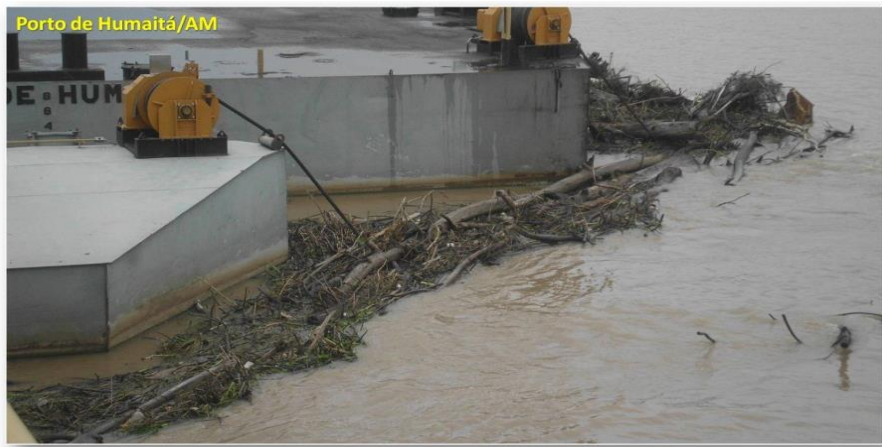
Figura 35: Acúmulo de material vegetal nos cabos – Porto de Humaitá/AM Fonte: Adm. Porto Humaitá.
