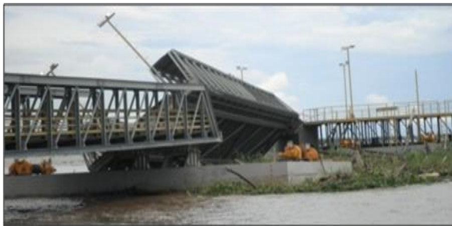
Figura 42: Incidente ocorrido no Porto de Manacapuru/AM. Fonte: http://canalitacoatiara.com.br .
