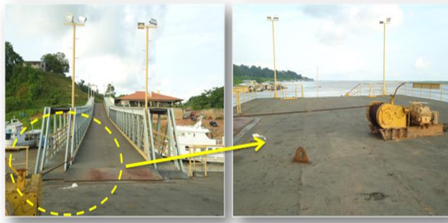
Figura 47: Linhas de ancoragem danificadas – Cais instável. Fonte: SMA/DPatr.
