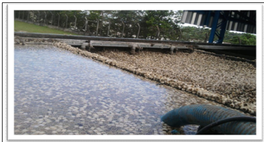
Figura 4.17 – Imagem da alta quantidade de lodo no reator biológico e deslocamento das biomédias.
