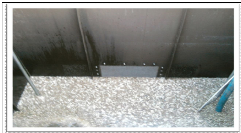
Figura 4.18 – Entupimento das telas dentro da ETE..
