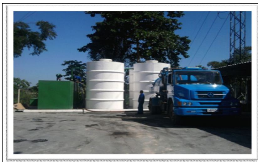
Figura 4.15 – Remoção de Lodo do Tanque de Sedimentação e Reator biológico. Fonte: MARTINS, A. G. (2013).
