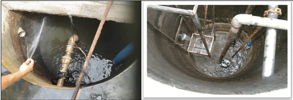
Figura 4.7 – Elevatória Fonte: MARTINS, A. G. (2013).
