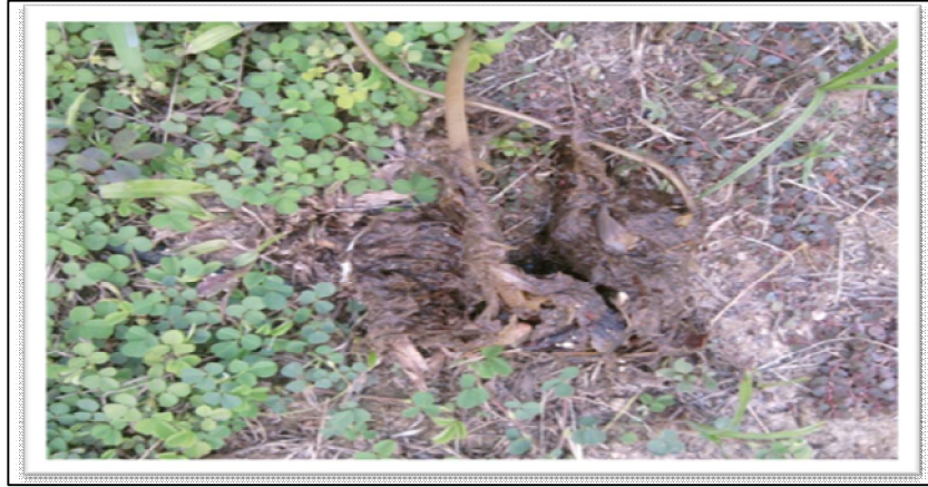
Figura 4.19 – Elevatória entupida com resíduo devido à falta de capina Fonte: MARTINS, A. G. (2013)
