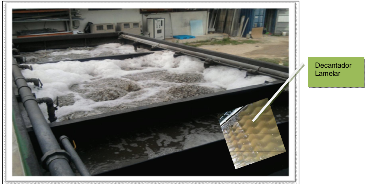
Figura 4.9 – Reator aeróbio biológico com MBBR.
